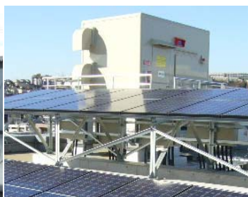
事業所用蓄電池
