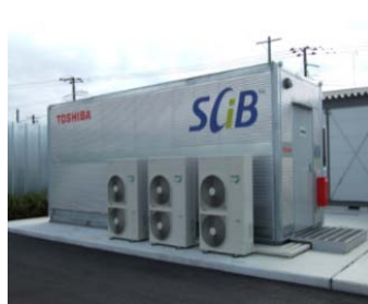
東京電力綱島変電所に設置した大規模蓄電池
