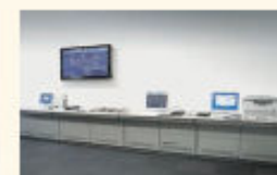
中央監視制御システム
