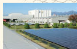
太陽光発電システム
