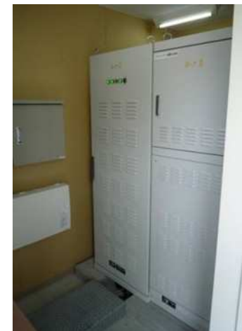
■ 集会所の 大型蓄電池
