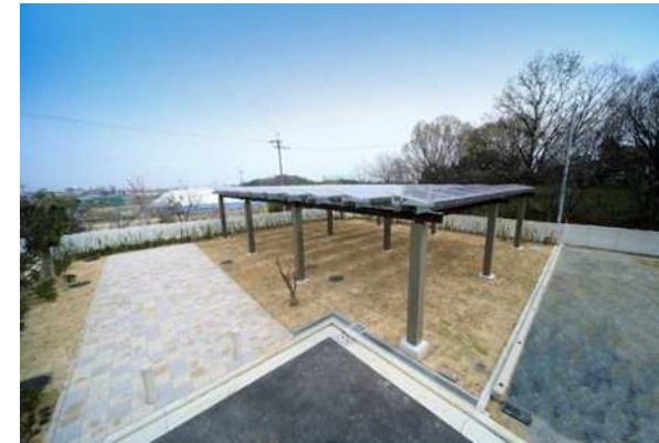
■ 調整池上部の 太陽光発電システム
